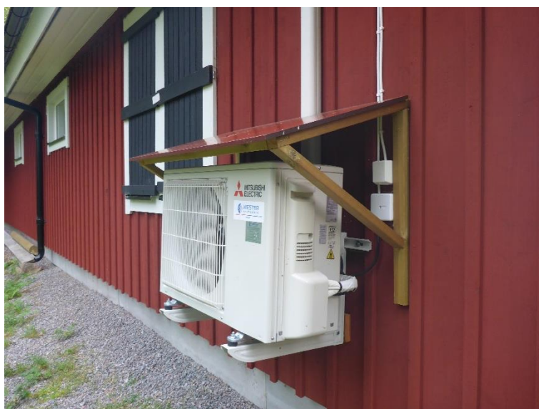
Utomhus installationen av luftvärmepumpen
