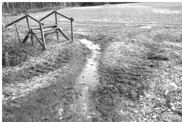
Skador på milspåret vid ca. 5 km. april
